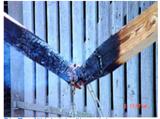
Die Tragfähigkeit ist überschritten.
