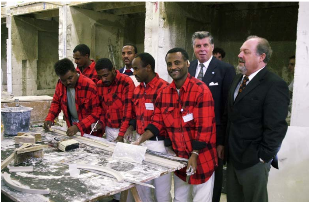
Trockenbaupraktikum der äthiopischen Ausbilder in der Stukkateurwerkstatt des BZB Krefeld; im Bild BZB-Vorsitzender Herbert Schaefer (2.v.r.) und BZB-Geschäftsführer Dipl.-Ing. Frank Pawlik (r.)
